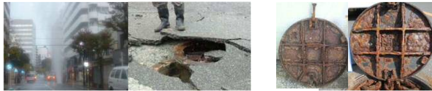
内圧による蓋の浮上飛散 ⇒ 事故
