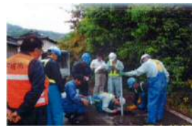
(出典:平成28年 熊本地震における管路協の対応-管路協)
